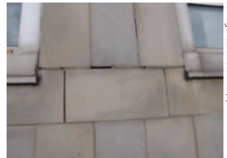
Bild 1: Natursteinfassade aus den beginnenden 1960er Jahren: Fassadenaufbau mit einem gerissenen Fugennetz (Regelfugenbreite von 3 -5 mm)
