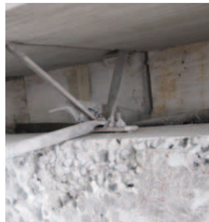
Bild 6: Kreuz und quer verschweißte Anker an einer Natursteinfassade.
