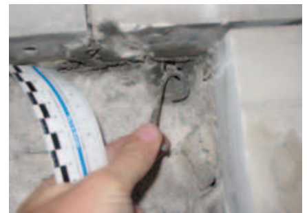
Bild 2: Eine genaue Begutachtung macht die Fugenschädigungen sichtbar.
